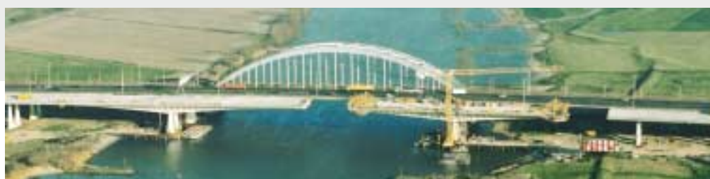
Cassaforma per conci gettati a sbalzi simmetrici, per la campata principale del ponte Lek, in Olanda. Partendo dalle pile vicine alle sponde del fiume, la campata viene realizzata con conci a sezione scatolare precompressi su ciascun lato per circa 80 m, fino a raggiungere il centro della campata.
