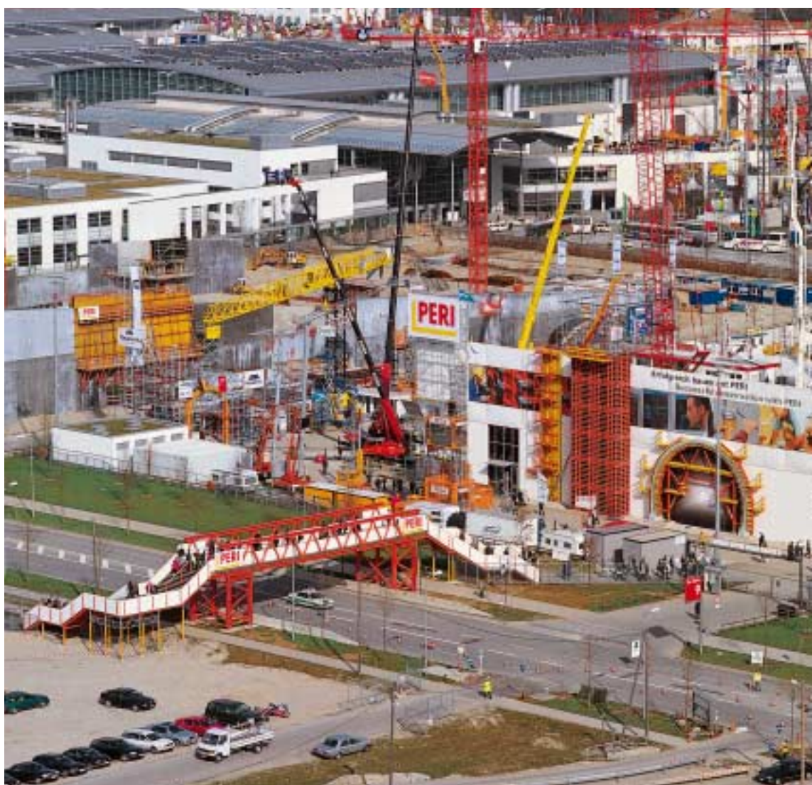
Sovrappasso temporaneo per il BAUMA 2001. Sullo sfondo è visibile il padiglione espositivo PERI.
