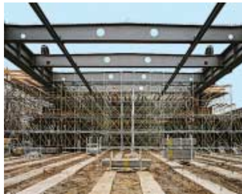
La travata composta in acciaio e cls in corrispondenza della sponda orientale: per la soletta dell'impalcato è stato impiegato PERI UP Rosett.
