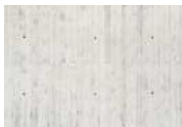
Il risultato è una finitura superficiale del cls, in questo caso con impronta in legno.
