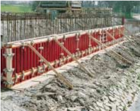
Costruzione del ponte di Acher. Fondazioni: cassaforma PERI con rivestimento in tavole di legno Impresa: Consorzio Bilfinger & Berger, Max Früh
