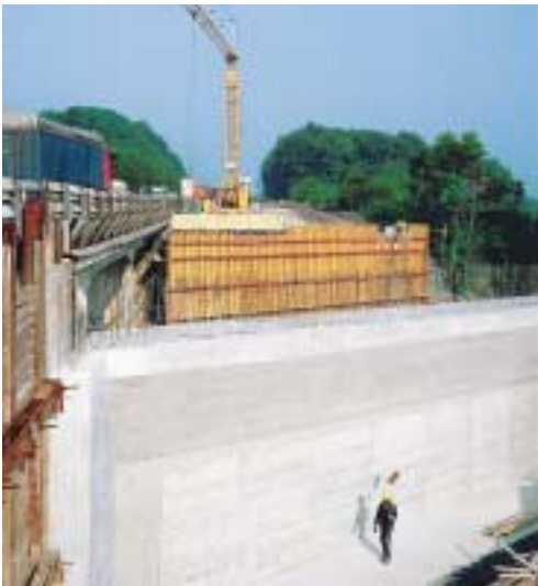
Sottopasso autostradale nei pressi di Kirchheim/Teck. Cassaforma a travi VARIO di notevole altezza. Impresa: Leonhard Weiss, Germania
