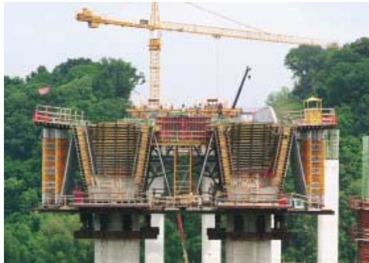
Per i conci delle teste pile delle pile accoppiate n. 9 sono stati utilizzati tra 620 e 860 m 2 di cassaforma.
