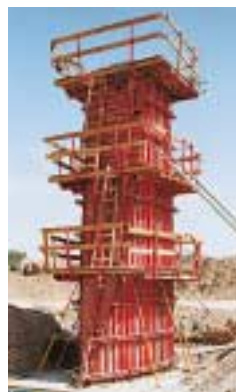
Cassaforma metallica specifica per le pile. La struttura è stata di facile impiego ed ha consentito di ottenere finiture del cls a vista di alto livello qualitativo.
