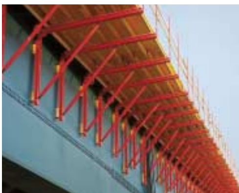
Cassaforma, supportata da mensole ogni 2 m, della soletta in c.a. con sbalzi.
