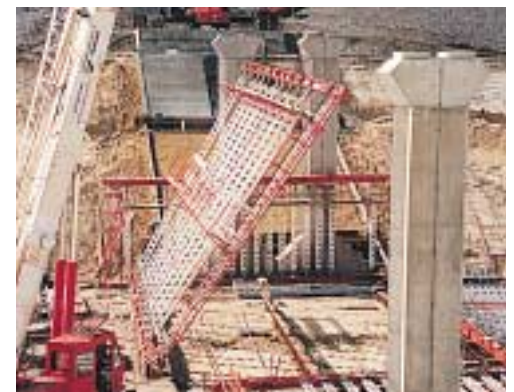
Una volta completato il preassemblaggio delle unità d'impalcature di sostegno, vengono erette le stilate di puntoni.
